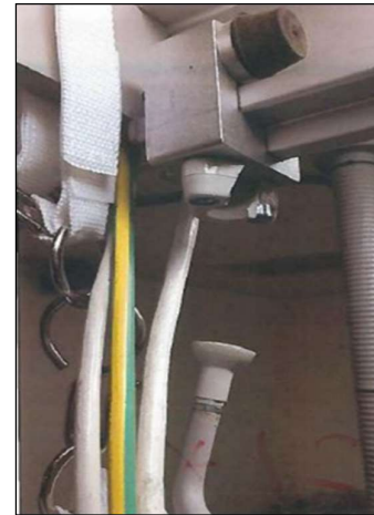
Carcasă rulment din plastic ruptă Aceasta va duce la căderea furtunului de cablu
